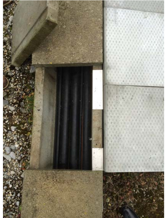
Abbildung 19: Rampen bei Grafenried; Detailansicht der INOX-Klammern bei geöffnetem Kabelkanal.
