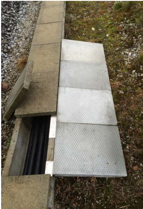
Abbildung 18: Rampen bei Grafenried, Deckel des Kabelkanals geöffnet; im Kabelkanal sichtbar sind die Kabel.
