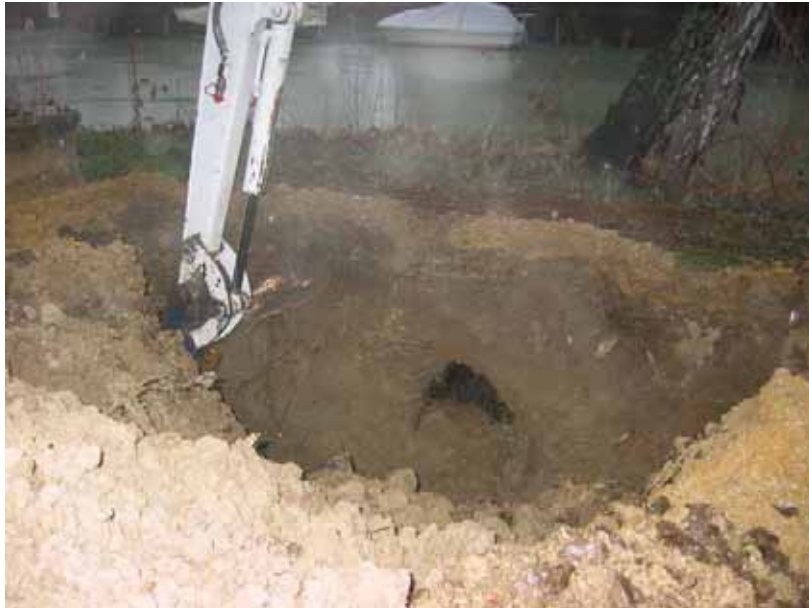
Abb. 6: Vom Biber gegrabene Röhre, die zum Einsturz des Uferwegs am Zihlkanal bei Port (BE) führte.
