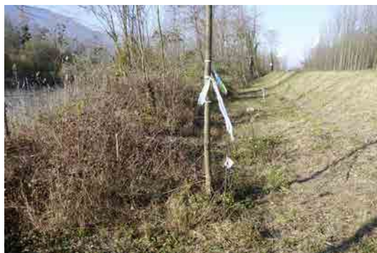
Abb. 2: Lage der Biberbauten im Vordamm des Hochwasserschutzdammes der Rhone ist mit Plastikbändern markiert.
