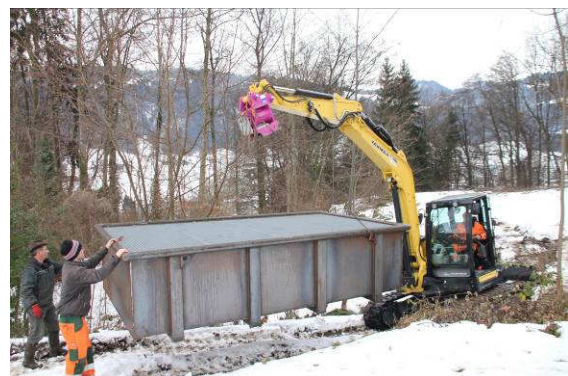
Diese Stahlwanne wurde speziell für uns konstruiert .... (Foto: Georges Müller)
