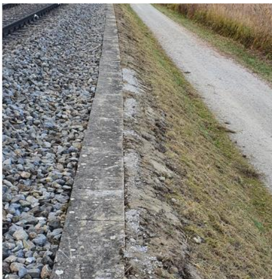
Canaux à câbles intégrés au talus afin d'éliminer un obstacle pour les amphibiens.
