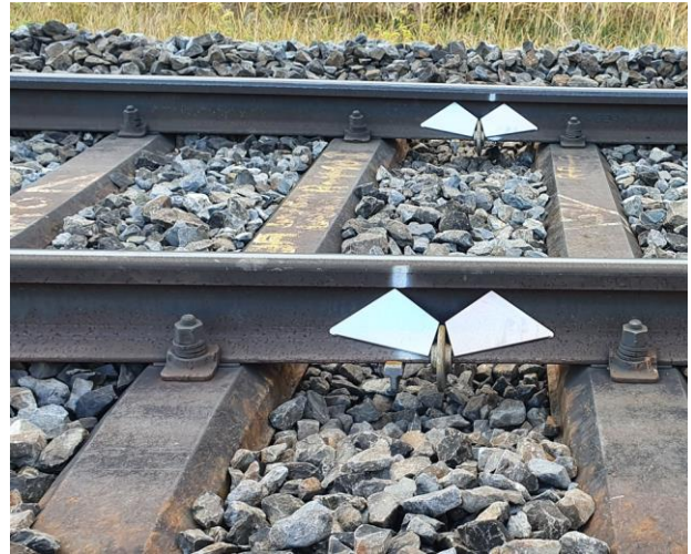
Eingleisiger Abschnitt, an dem der Schotter jeweils jedes 11.-12. Schwellenfach tiefer gekehrt ist. Stahlschwellen.
