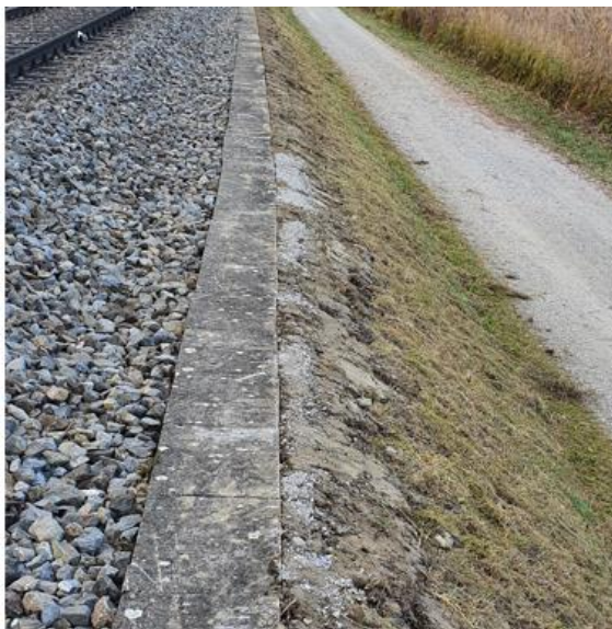
Kabelkanal anböschen, um ein Hindernis für Amphibien zu beseitigen.
