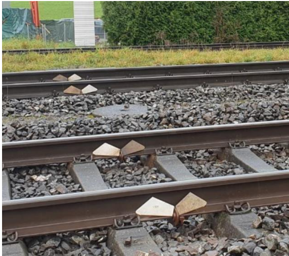
Zweigleisiger Abschnitt, an dem der Schotter jeweils in vier nachfolgenden Schwellenfächern jeweils jedes 15. Fach tiefer gekehrt ist. Betonschwellen.
