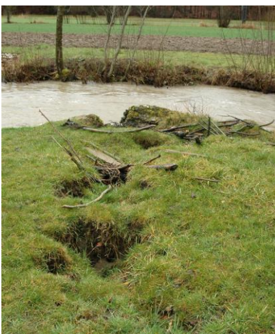
Eingestürzter, verlassener Erdbau.
