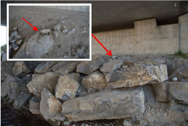
Abb. 11: Relativ hohe Brücke mit erhöhtem Bankett aus grossen Steinen. Die Markierungen befinden sich auf dem Bankett.
