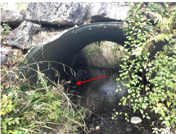
Abb. 9: Wellblechrohr als Durchlass unter einem Weg mit Bankett aus Steinen und Schlamm.
